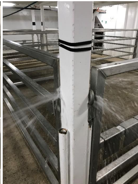
Fuite du système d'approvisionnement en eau
